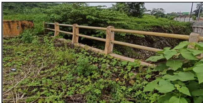
KONDISI SANDARAN SISI KIRI
