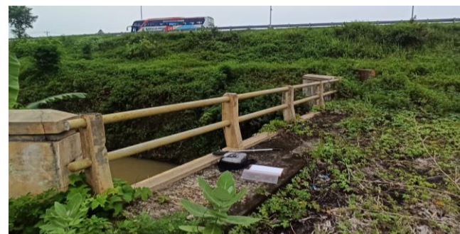
KONDISI SANDARAN SISI KANAN
