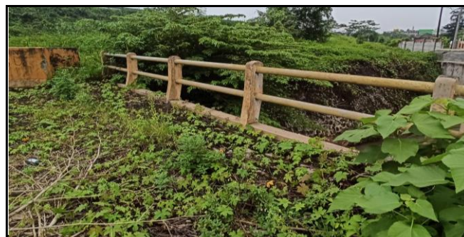
KONDISI SANDARAN SISI KIRI
