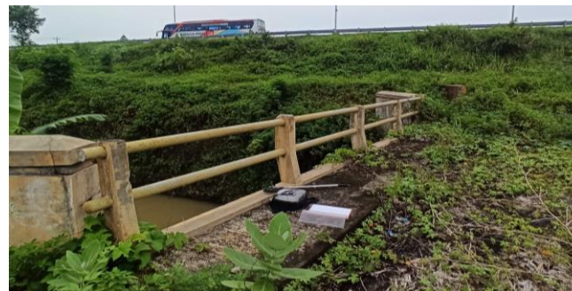
KONDISI SANDARAN SISI KANAN
