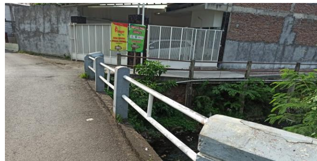
KONDISI SANDARAN SISI KANAN
