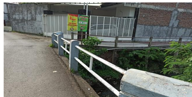
KONDISI SANDARAN SISI KANAN
