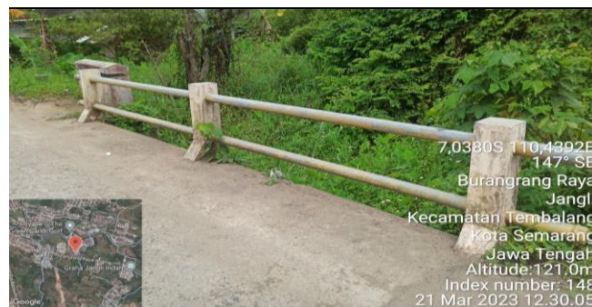
KONDISI SANDARAN SISI KANAN
