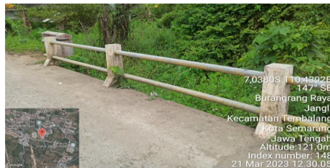
KONDISI SANDARAN SISI KANAN
