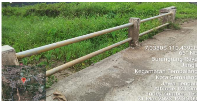
KONDISI SANDARAN SISI KIRI
