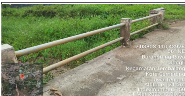
KONDISI SANDARAN SISI KIRI
