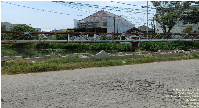
LANTAI JALAN BERGELOMBANG
