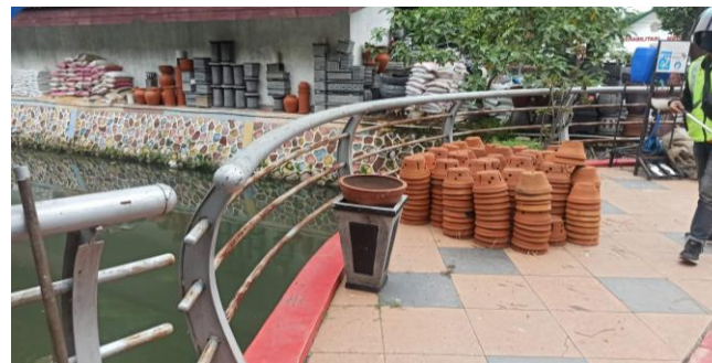
KONDISI SANDARAN SISI KANAN
