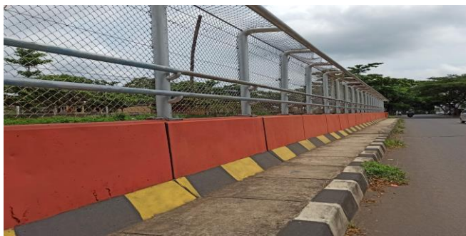
KONDISI SANDARAN SISI KIRI
