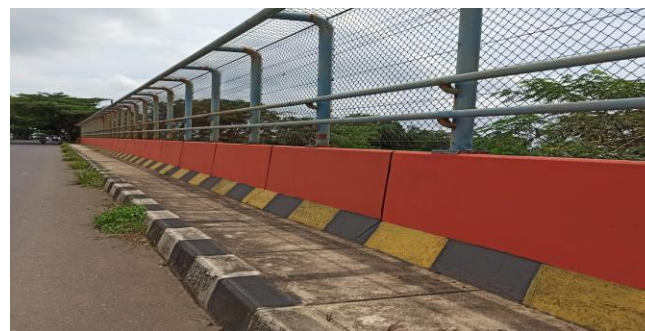
KONDISI SANDARAN SISI KANAN
