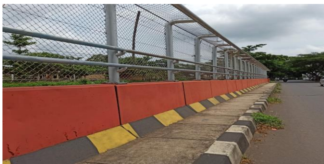
KONDISI SANDARAN SISI KIRI
