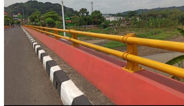
KONDISI SANDARAN SISI KANAN
