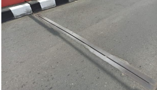
SAMBUNGAN LANTAI MENGLUPAS
