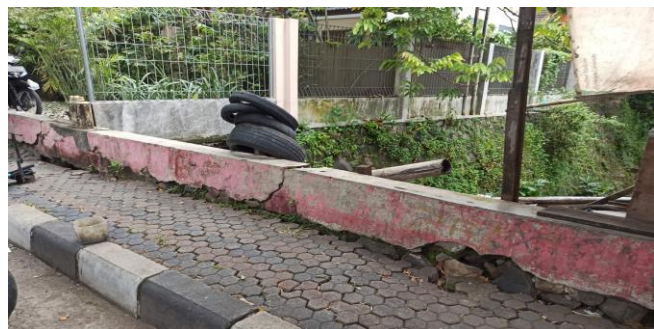
KONDISI SANDARAN SISI KIRI
