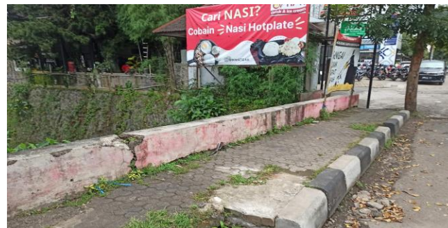
KONDISI SANDARAN SISI KANAN
