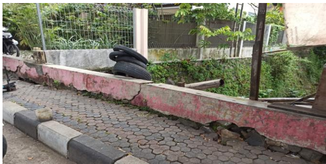
KONDISI SANDARAN SISI KIRI
