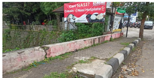
KONDISI SANDARAN SISI KANAN
