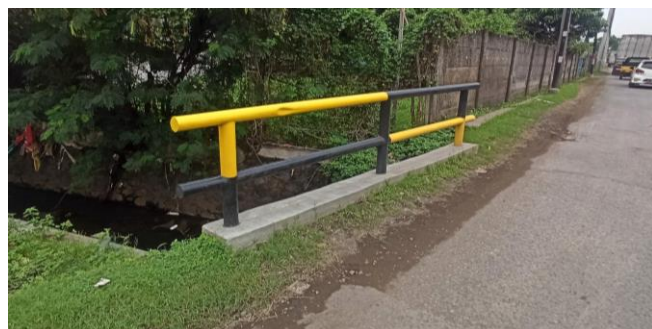
KONDISI SANDARAN SISI KIRI
