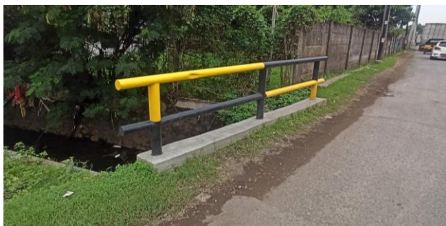
KONDISI SANDARAN SISI KIRI
