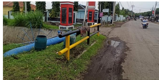
KONDISI SANDARAN SISI KANAN
