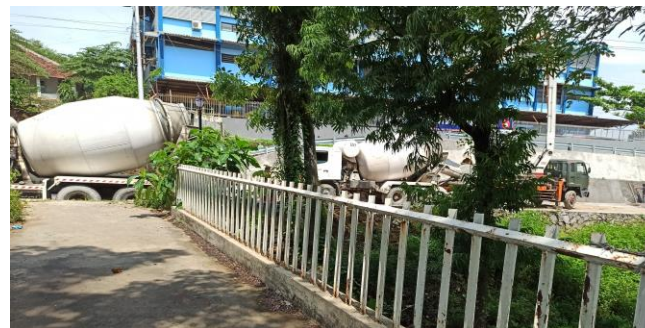
KONDISI SANDARAN SISI KANAN
