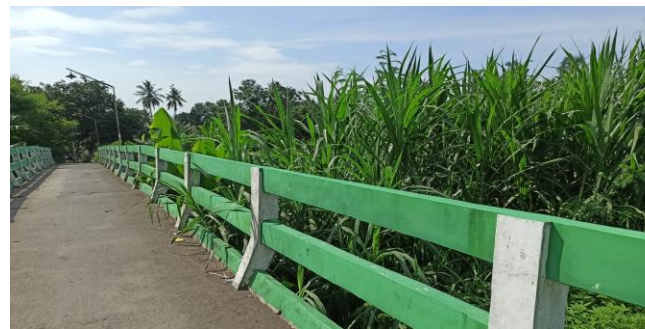
KONDISI SANDARAN SISI KANAN
