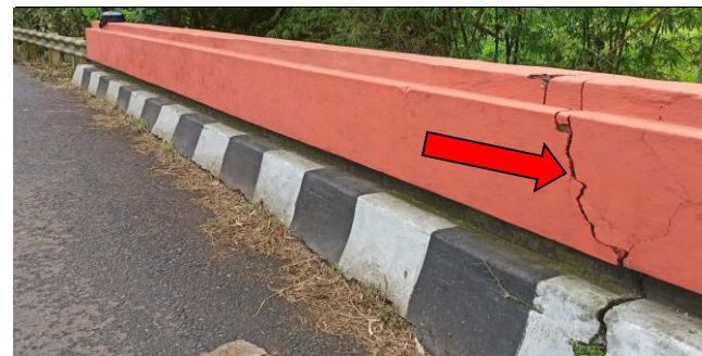
KONDISI SANDARAN SISI KANAN PECAH
