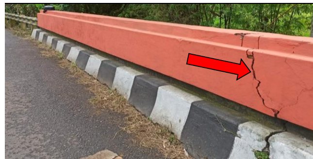
KONDISI SANDARAN SISI KANAN PECAH
