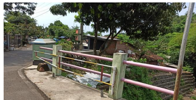
KONDISI SANDARAN SISI KANAN
