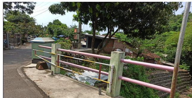
KONDISI SANDARAN SISI KANAN
