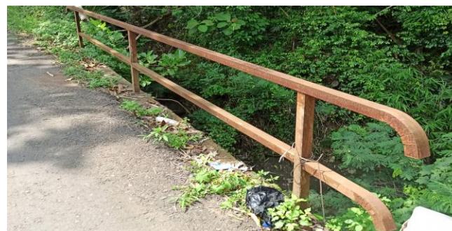
KONDISI SANDARAN SISI KANAN
