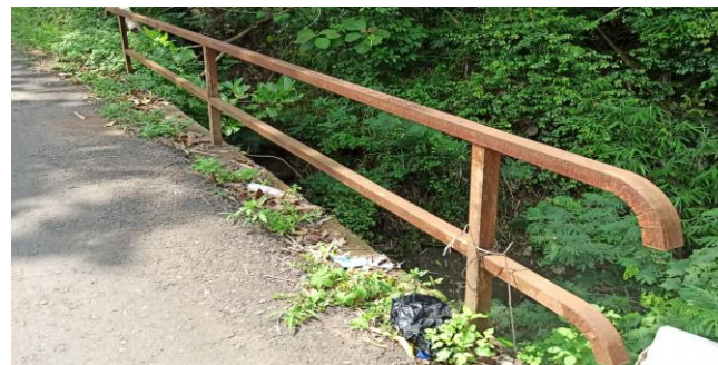
KONDISI SANDARAN SISI KANAN
