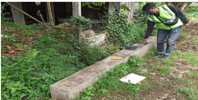
KONDISI SANDARAN SISI KIRI
