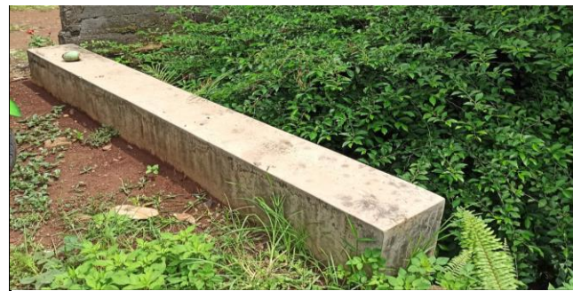
KONDISI SANDARAN SISI KANAN
