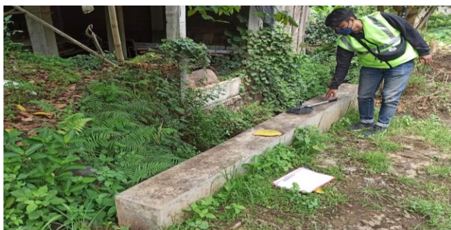
KONDISI SANDARAN SISI KIRI
