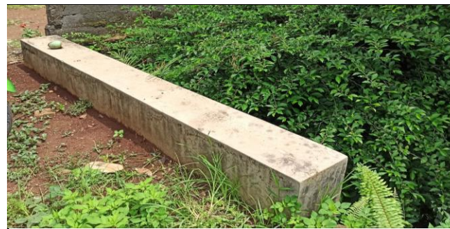
KONDISI SANDARAN SISI KANAN
