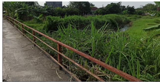
KONDISI SANDARAN SISI KANAN
