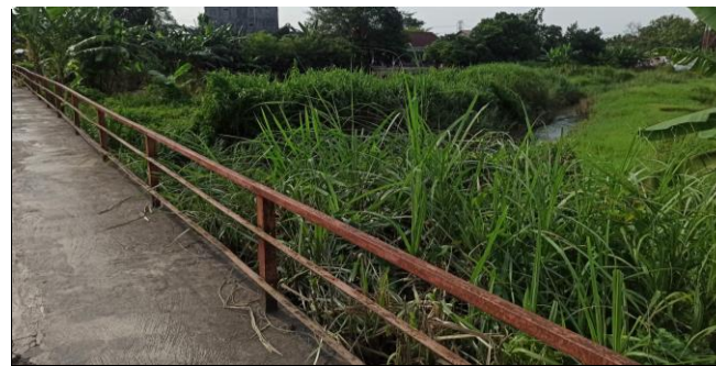
KONDISI SANDARAN SISI KANAN
