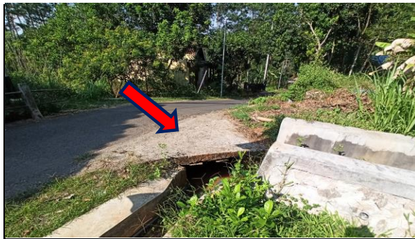
TIDAK ADA SANDARAN DI SISI KIRI
