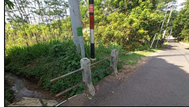
KONDISI SANDARAN SISI KANAN
