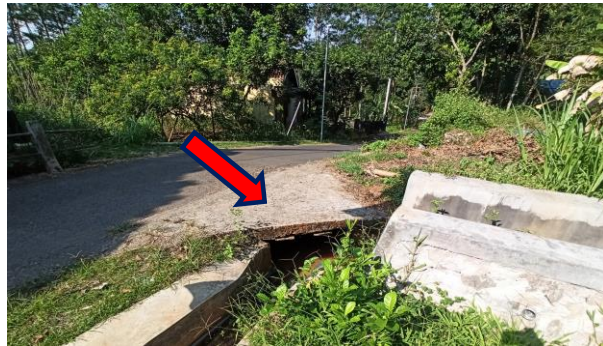
TIDAK ADA SANDARAN DI SISI KIRI
