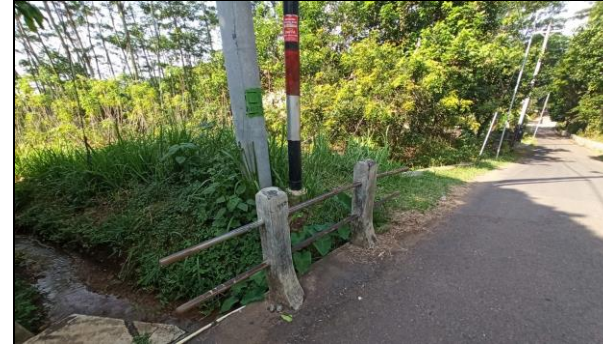
KONDISI SANDARAN SISI KANAN
