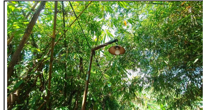
KONDISI LAMPU PENERANGAN JEMBATAN
