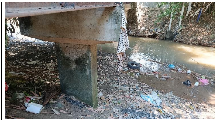
KONDISI PILAR BERLUMUT
