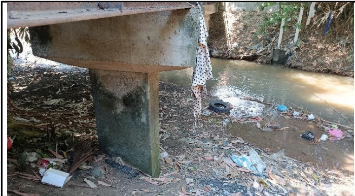
KONDISI PILAR BERLUMUT
