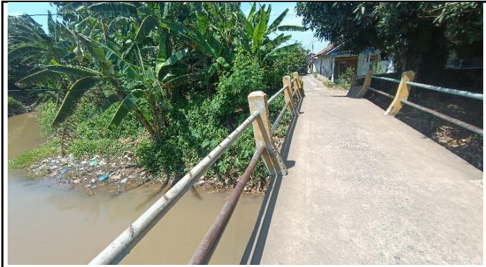
KONDISI LANTAI DAN SANDARAN
