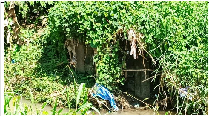
KONDISI BEKAS KEPALA JEMBATAN
