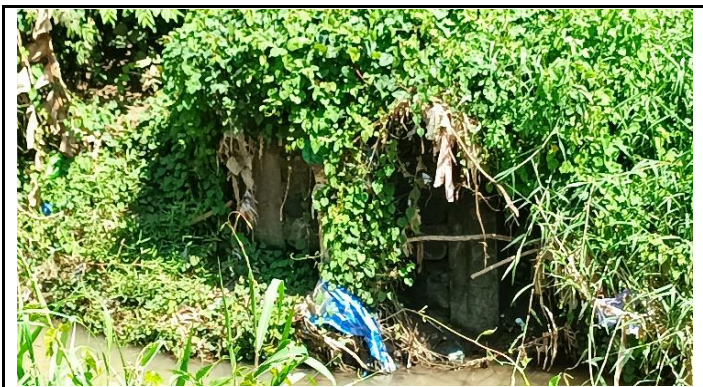
KONDISI BEKAS KEPALA JEMBATAN
