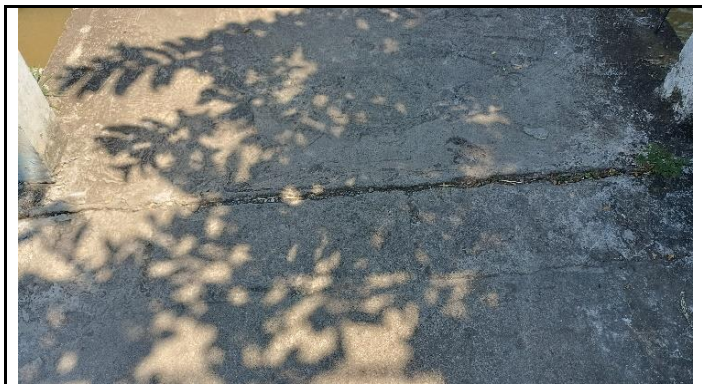
KONDISI LANTAI JEMBATAN BERGELOMBANG
