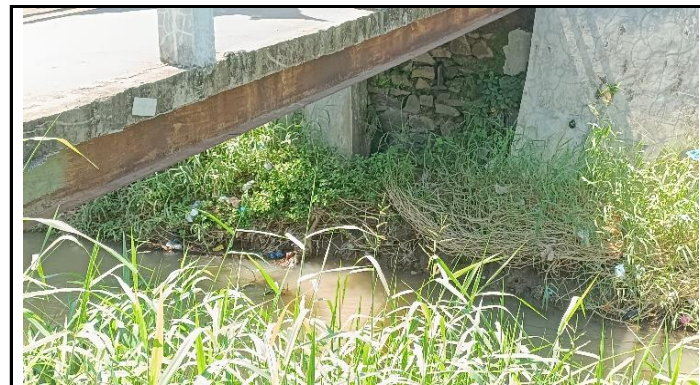
GELAGAR BERKARAT DAN KONDISI KEPALA JEMBATAN
