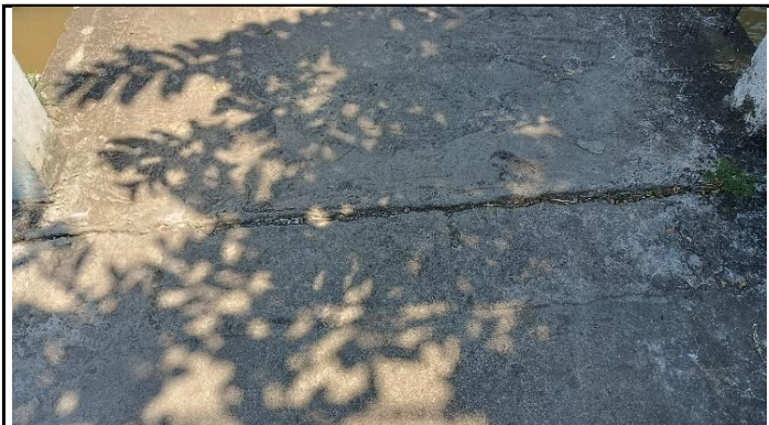
KONDISI LANTAI JEMBATAN BERGELOMBANG
