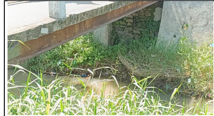
GELAGAR BERKARAT DAN KONDISI KEPALA JEMBATAN
