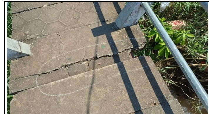
KONDISI LANTAI JEMBATAN RETAK
