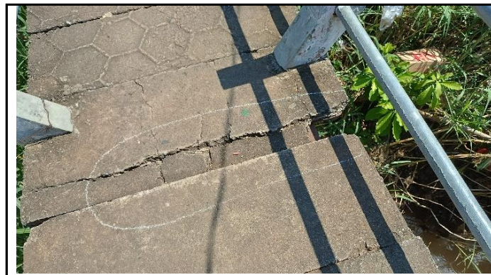
KONDISI LANTAI JEMBATAN RETAK
