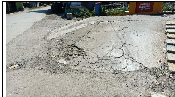
KONDISI JALAN PEDEKAT BERLUBANG
