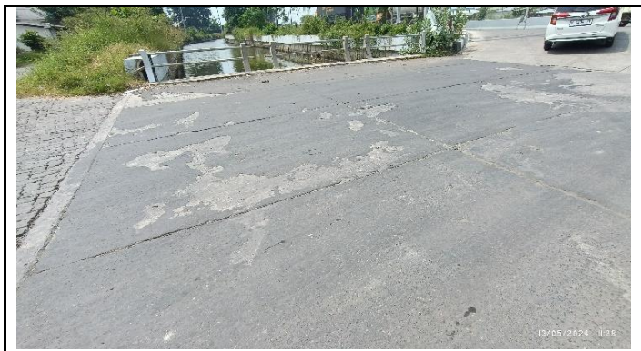
LAPISAN PERMUKAAN LANTAI BERGELOMBANG
