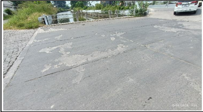
LAPISAN PERMUKAAN LANTAI BERGELOMBANG
