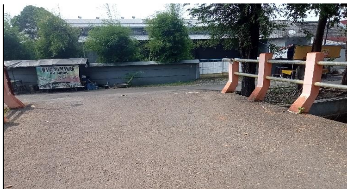
KONDISI LAPISAN PERMUKAAN LANTAI
