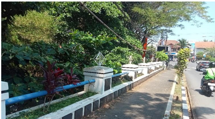
KONDISI SANDARAN DAN TROTOAR
