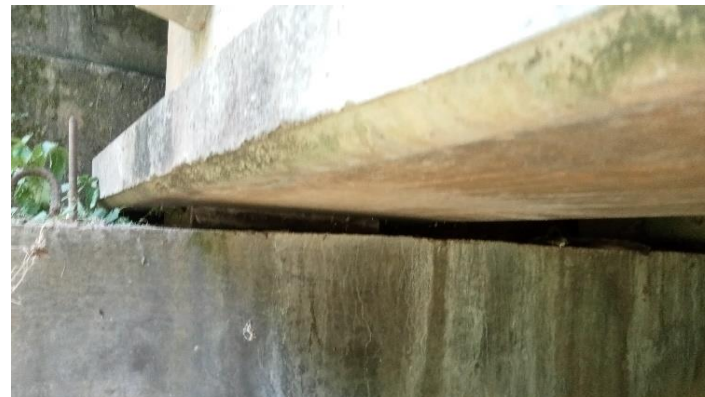
KONDISI LADASAN ELASTOMER
