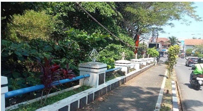
KONDISI SANDARAN DAN TROTOAR
