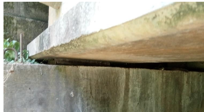
KONDISI LADASAN ELASTOMER
