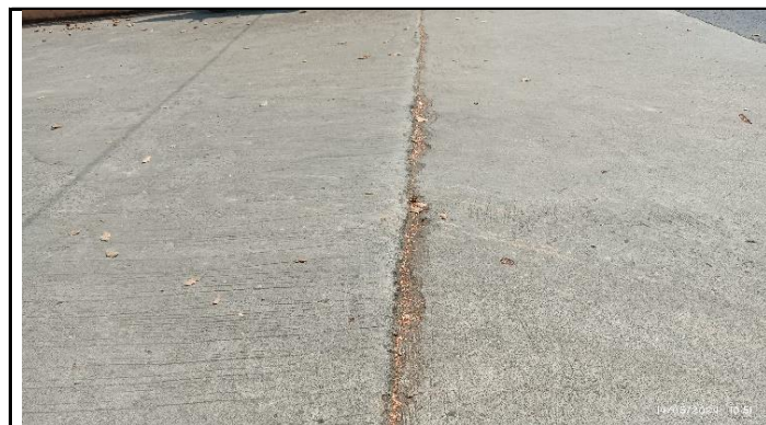
KONDISI LANTAI BERLUBANG PADA SAMBUNGAN
