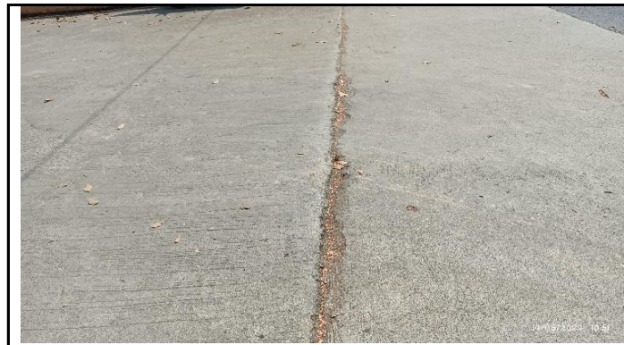
KONDISI LANTAI BERLUBANG PADA SAMBUNGAN
