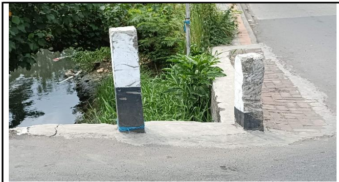
TIANG PENGAMAN JALAN PENDEKAT RETAK
