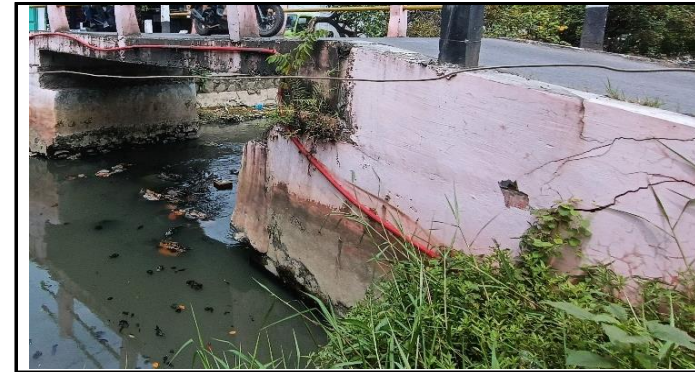
KERETAKAN PADA DINDING PENAHAN TANAH JALAN PENDEKAT
