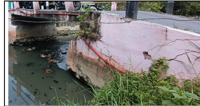
KERETAKAN PADA DINDING PENAHAN TANAH JALAN PENDEKAT
