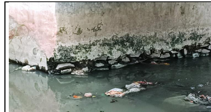
PONDASI LANGSUNG JEMBATAN TERGERUS
