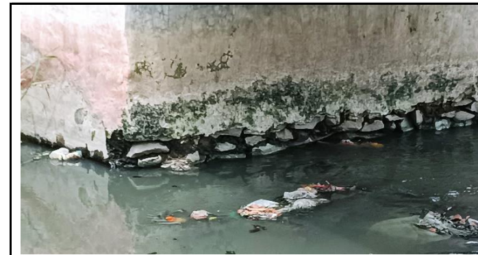
PONDASI LANGSUNG JEMBATAN TERGERUS
