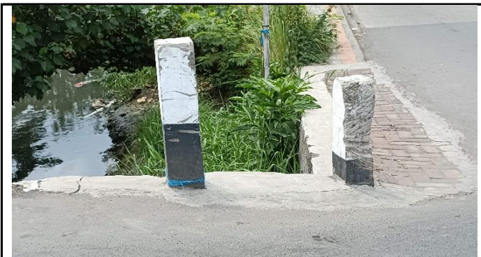
TIANG PENGAMAN JALAN PENDEKAT RETAK
