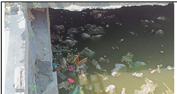
PENUMPUKAN DEBRIS (SAMPAH) PADA ALIRAN SUNGAI
