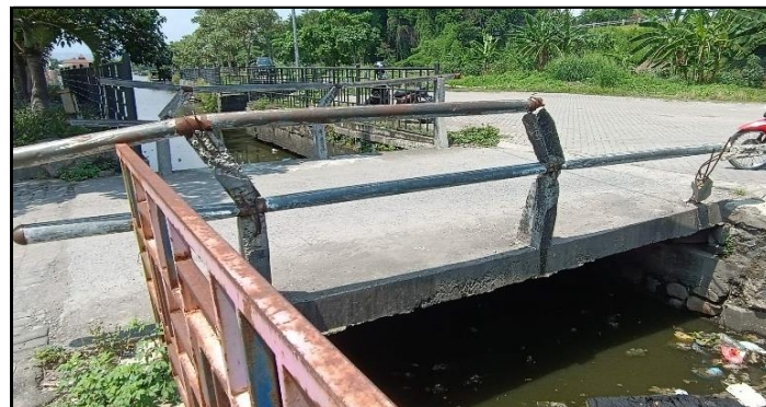
KERUSAKAN PADA SANDARAN JEMBATAN
