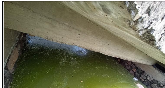
KERONTOKAN BETON PADA STRUKTUR LANTAI
