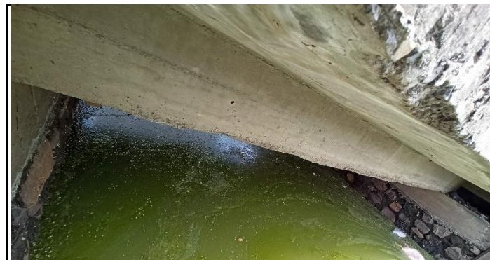
KERONTOKAN BETON PADA STRUKTUR LANTAI
