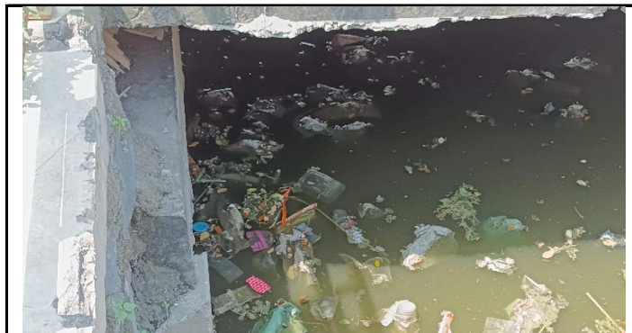
PENUMPUKAN DEBRIS (SAMPAH) PADA ALIRAN SUNGAI
