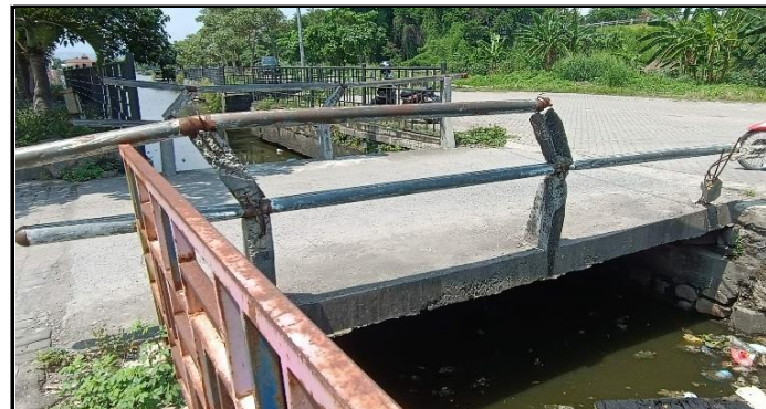
KERUSAKAN PADA SANDARAN JEMBATAN
