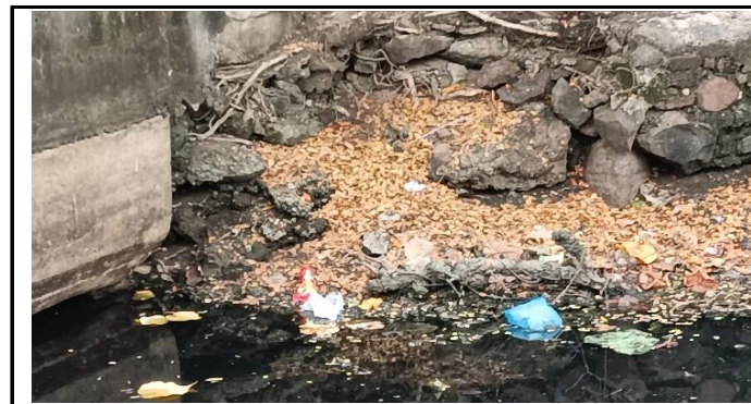
KERONTOKAN BETON PADA TEBING SUNGAI
