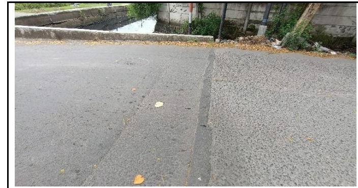
KERUSAKAN PADA SAMBUNGAN JALAN PENDEKAT
