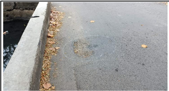
KONDISI LAPISAN PERMUKAAN LANTAI BERLUBANG
