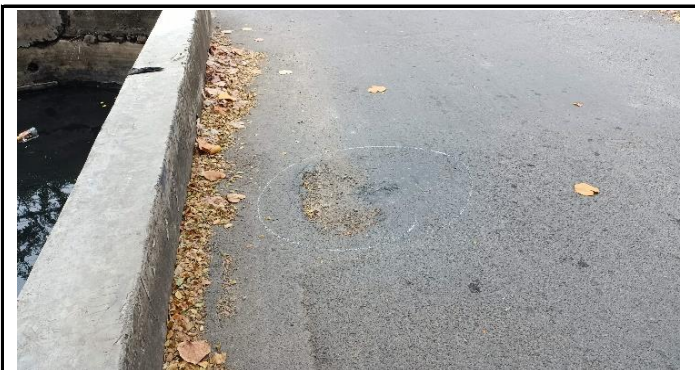
KONDISI LAPISAN PERMUKAAN LANTAI BERLUBANG
