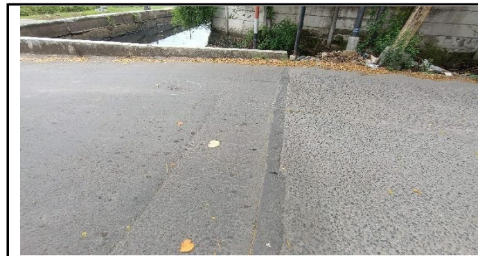
KERUSAKAN PADA SAMBUNGAN JALAN PENDEKAT
