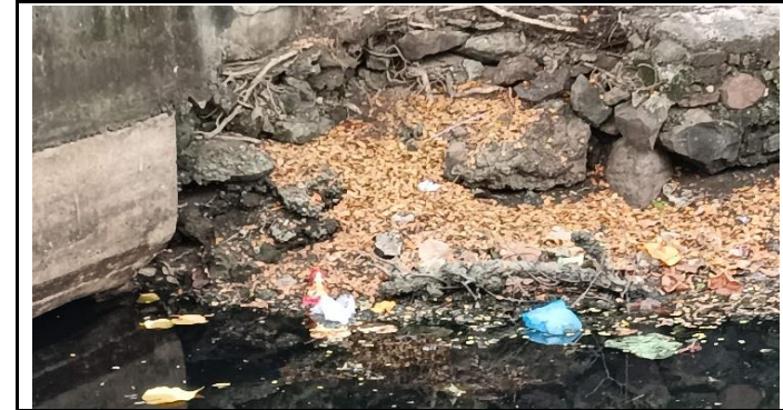
KERONTOKAN BETON PADA TEBING SUNGAI
