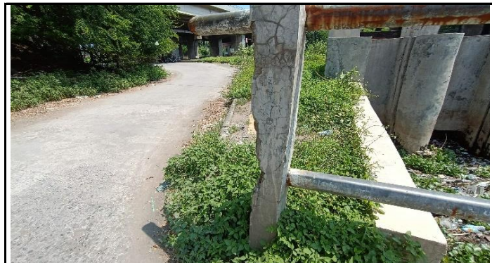
KERONTOKAN BETON PADA TIANG SANDARAN
