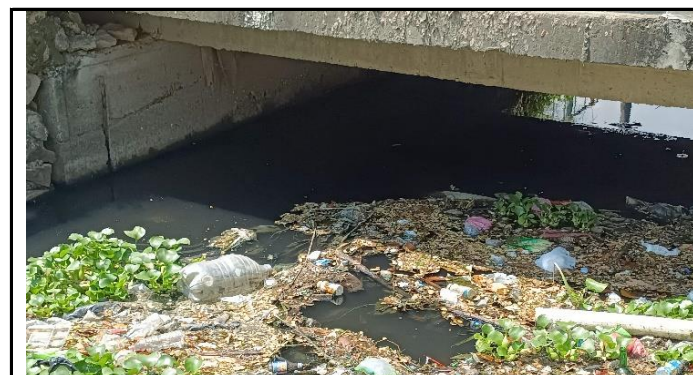
PENUMPUKAN DEBRIS (SAMPAH) PADA ALIRAN SUNGAI
