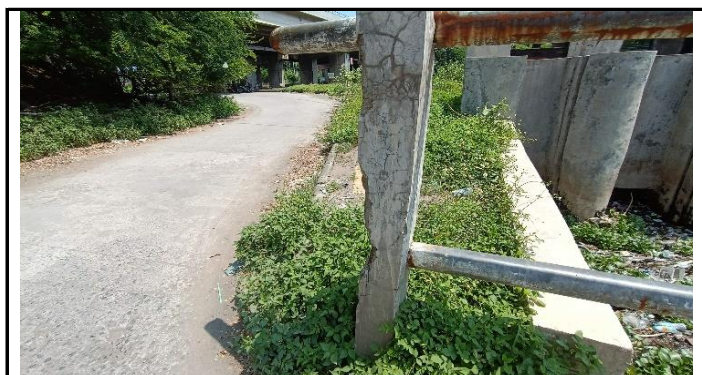
KERONTOKAN BETON PADA TIANG SANDARAN
