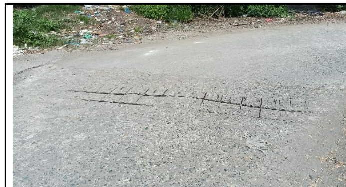
LANTAI JEMBATAN TERKELUPAS
