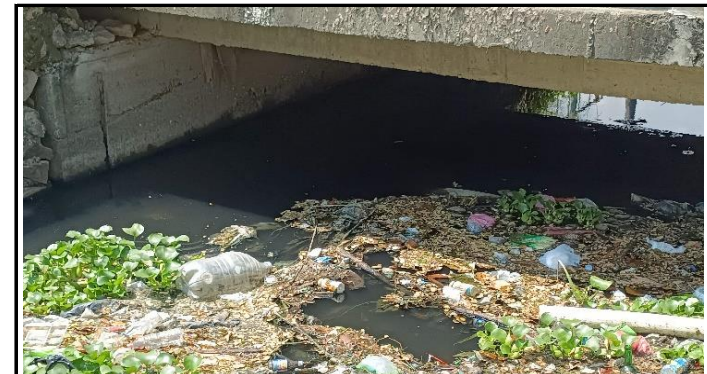
PENUMPUKAN DEBRIS (SAMPAH) PADA ALIRAN SUNGAI
