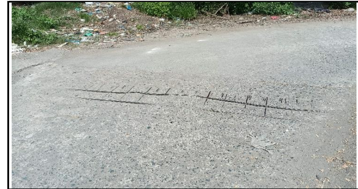
LANTAI JEMBATAN TERKELUPAS
