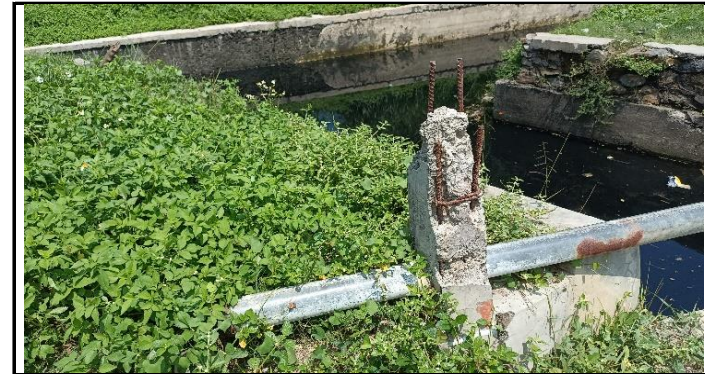
LANTAI JEMBATAN TERKELUPAS
