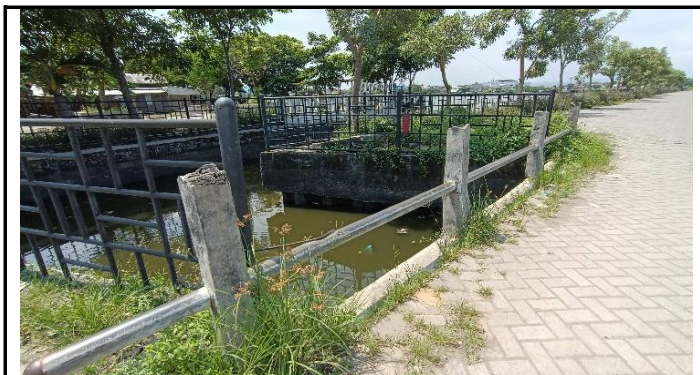
SANDARAN HORIZONTAL HILANG PADA SALAH SATU BAGIAN
