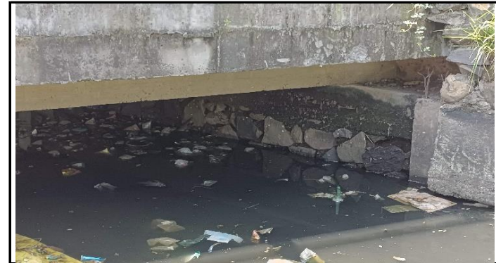
PENUMPUKAN DEBRIS (SAMPAH) PADA ALIRAN SUNGAI
