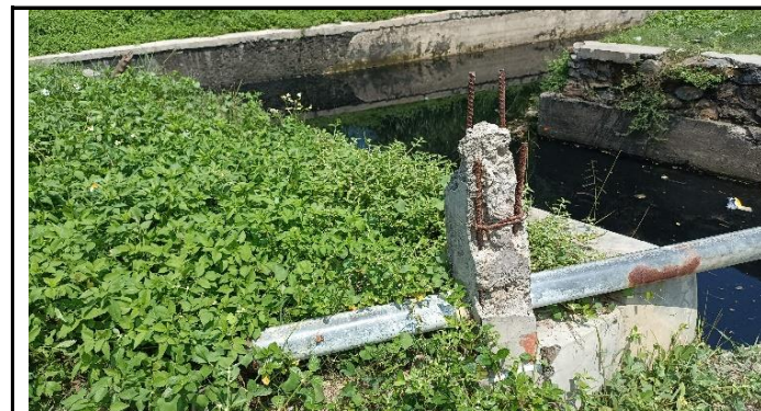
TIANG SANDARAN PECAH
