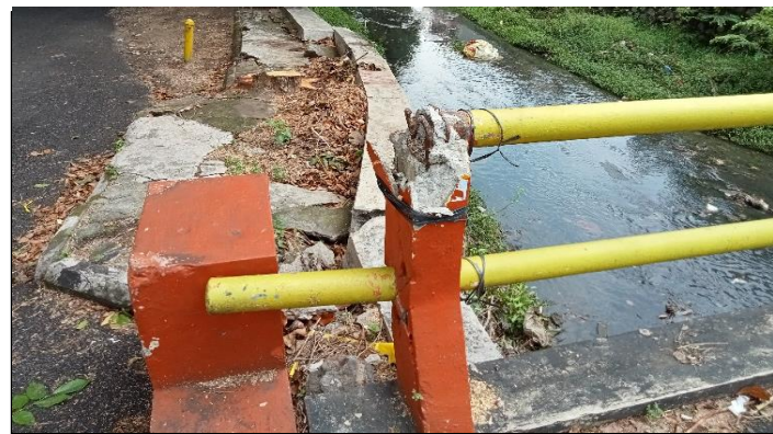
TIANG SANDARAN PECAH
