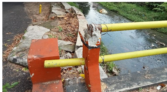
TIANG SANDARAN PECAH
