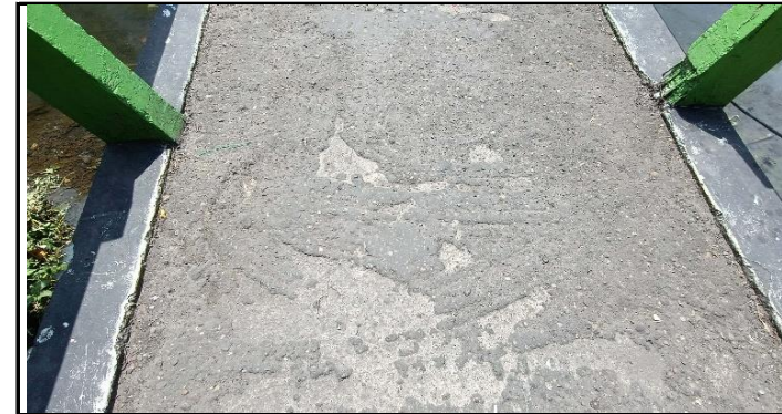
LAPISAN PERMUKAAN LANTAI BERGELOMBANG
