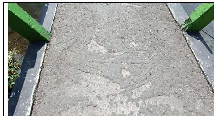
LAPISAN PERMUKAAN LANTAI BERGELOMBANG
