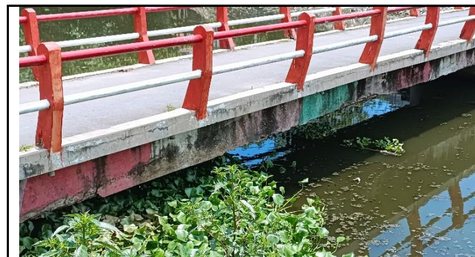
GELAGAR MENGALAMI PELAPUKAN DAN PENUAAN
