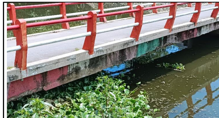
GELAGAR MENGALAMI PELAPUKAN DAN PENUAAN
