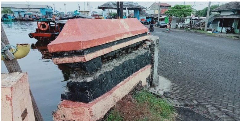
TEMBOK SEDADA/PARAPET PECAH
