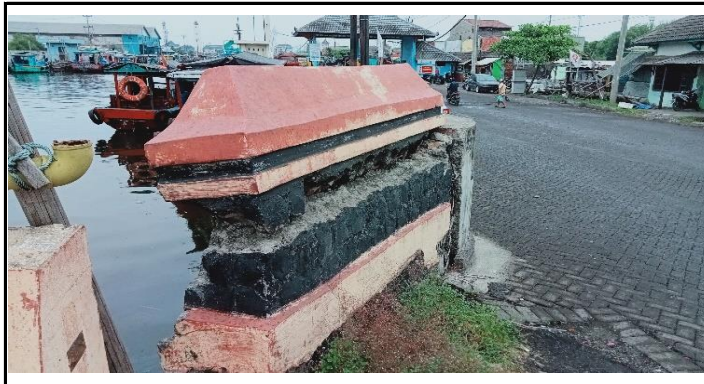
TEMBOK SEDADA/PARAPET PECAH
