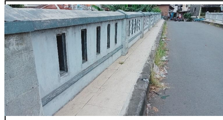
KONDISI SANDARAN DAN TROTOAR
