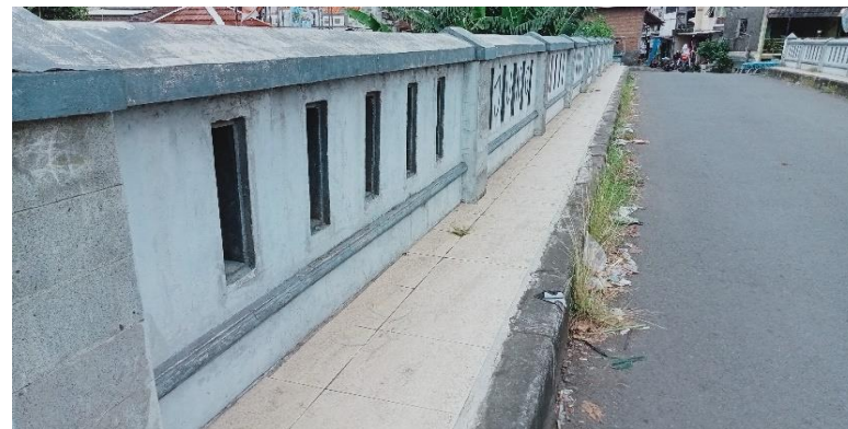
KONDISI SANDARAN DAN TROTOAR
