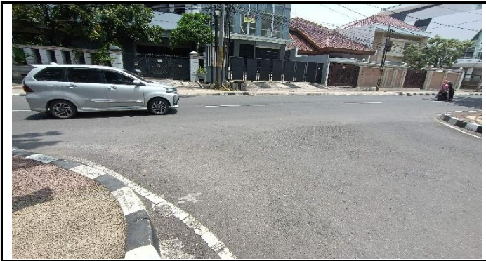
KONDISI JALAN PENDEKAT JEMBATAN
