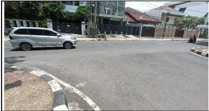
KONDISI JALAN PENDEKAT JEMBATAN
