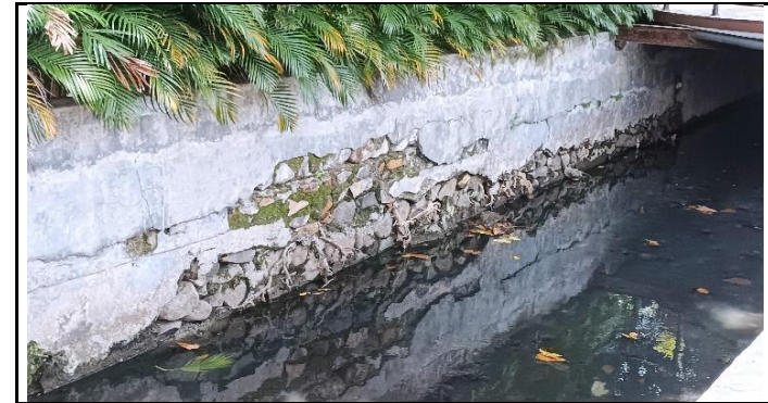
KERONTOKAN BETON PADA TEBING SUNGAI
