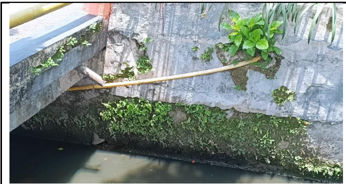
KEPALA JEMBATAN BERLUMUT DAN KOTOR
