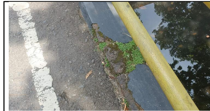
STRUKTUR LANTAI JEMBATAN BERLUMUT DAN KOTOR
