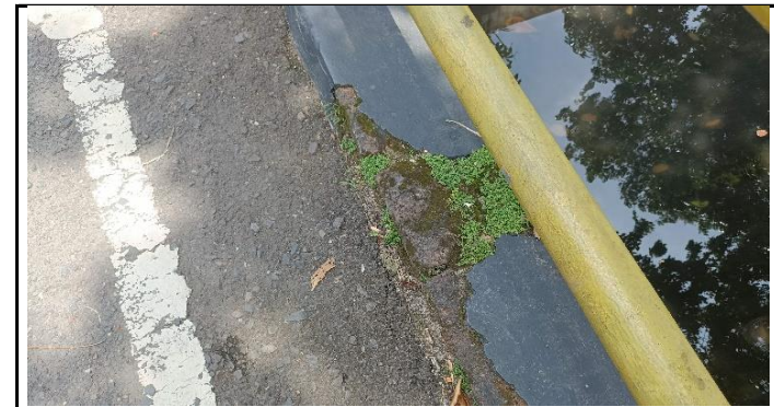
STRUKTUR LANTAI JEMBATAN BERLUMUT DAN KOTOR
