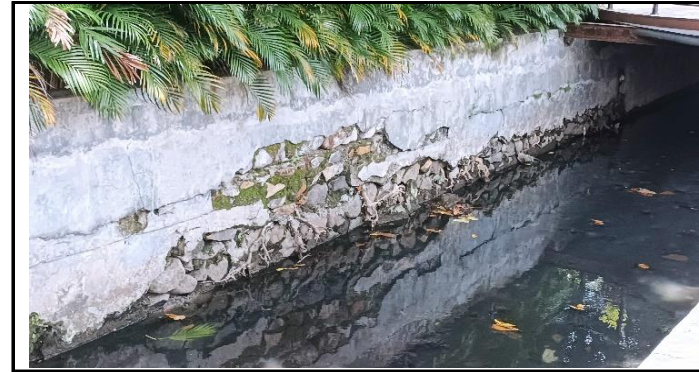
KERONTOKAN BETON PADA TEBING SUNGAI
