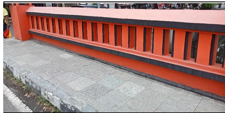
KONDISI SANDARAN DAN TROTOAR
