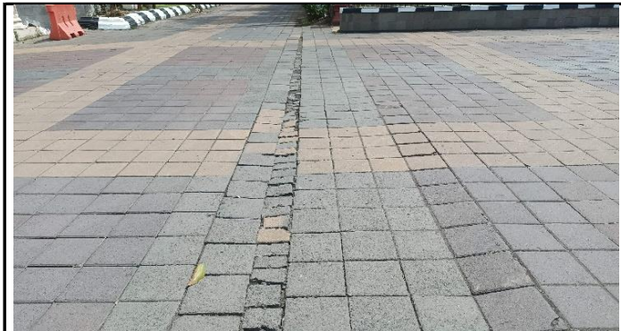
JALAN PENDEKAT BERLUBANG
