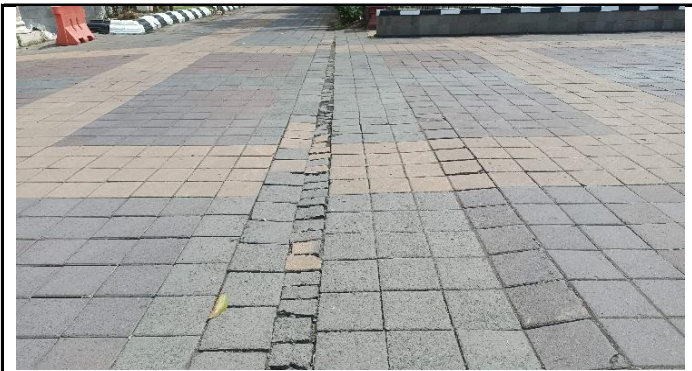
JALAN PENDEKAT BERLUBANG
