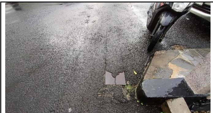
KONDISI EXPANTION JOINT (SAMBUNGAN SIAR MUAI)
