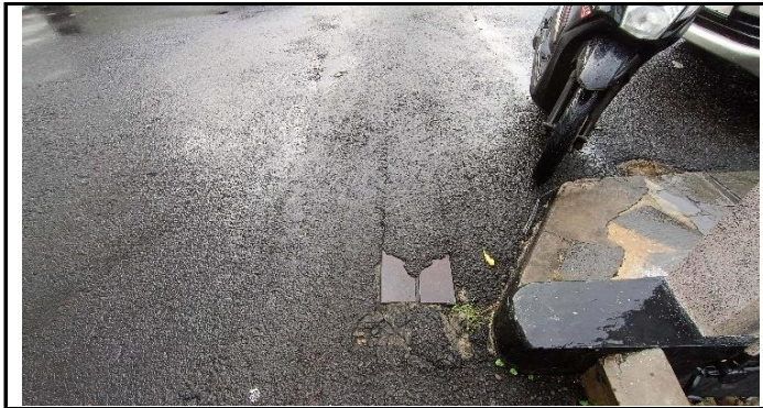
KONDISI EXPANTION JOINT (SAMBUNGAN SIAR MUAD)
