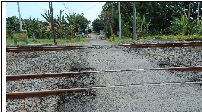
LAPISAN PERMUKAAN LANTAI BERLUBANG
