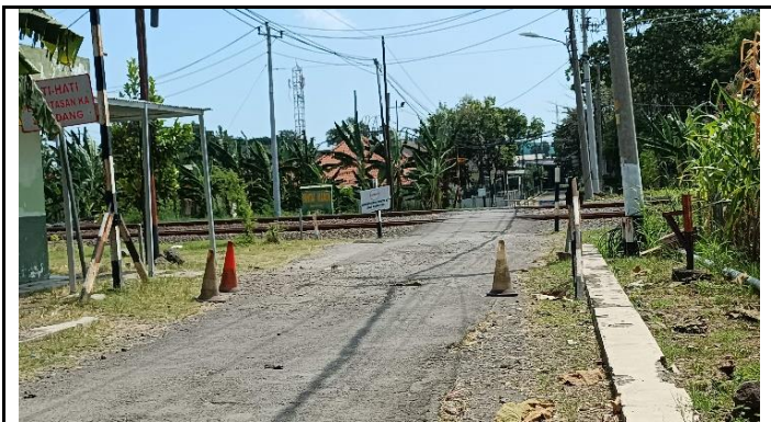
KONDISI JALAN PENDEKAT MENGALAMI KERUSAK
