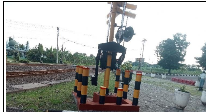
KONDISI PALANG PINTU PERLINTASAN KA
