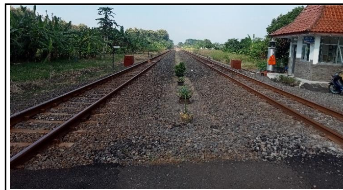
KONDISI REL KERETA API
