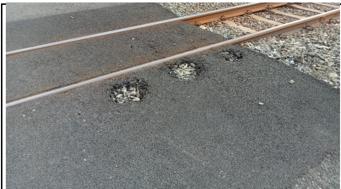
LAPISAN PERMUKAAN LANTAI BERLUBANG
