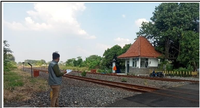
KONDISI REL KERETA API
