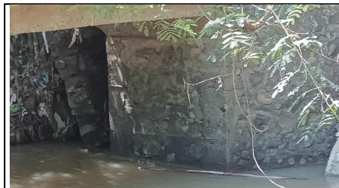
KEPALA JEMBATAN PECAH
