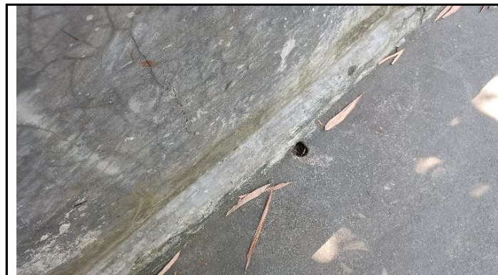
KONDISI PIPA CUCURAN AIR
