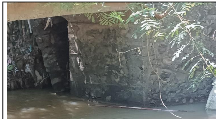
KEPALA JEMBATAN PECAH
