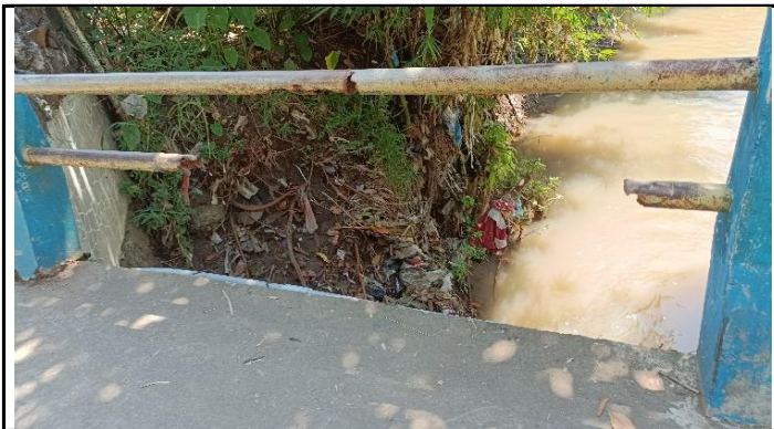
SANDARAN HORIZONTAL PECAH
