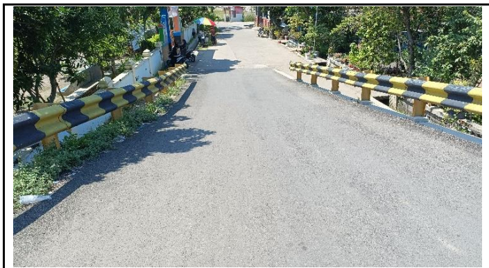
JALAN PENDEKAT DAN PENGAMAN PENGGUNA JALAN (GUARD RAILL)
