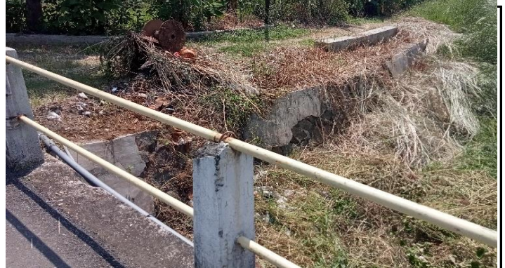
TIANG SANDARAN PECAH
