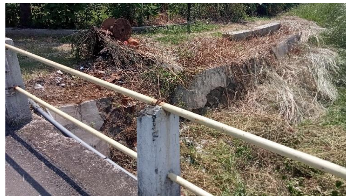
TIANG SANDARAN PECAH
