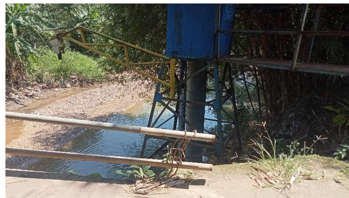
TIANG SANDARAN PECAH
