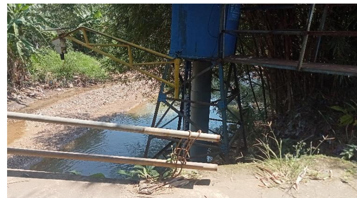
TIANG SANDARAN PECAH
