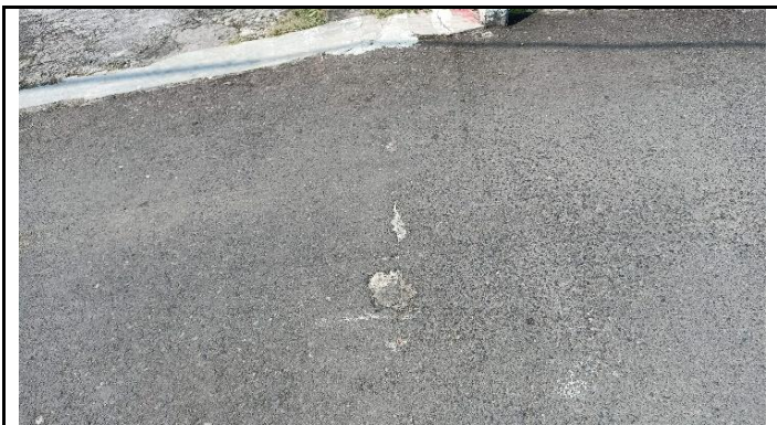
LAPISAN PERMUKAAN LANTAI BERLUBANG
