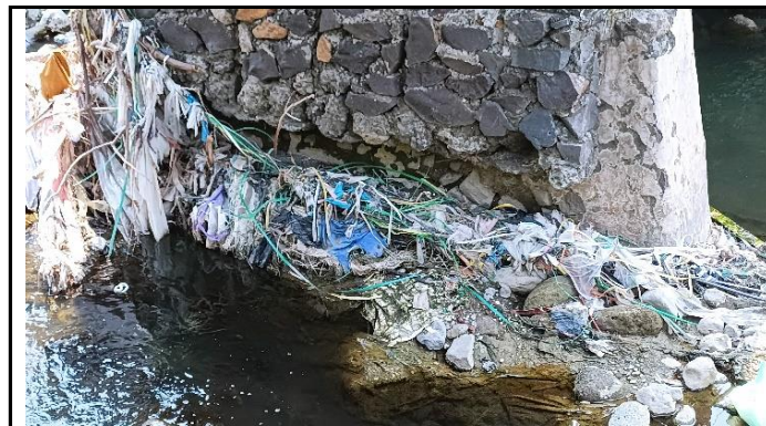
KONDISI PILAR TERJADI PENUMPUKAN SAMPAH
