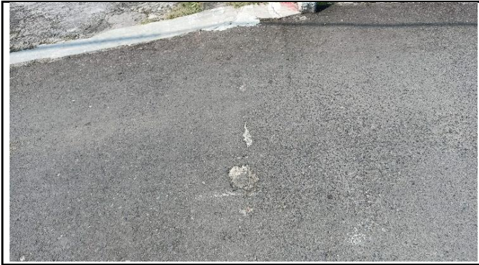
LAPISAN PERMUKAAN LANTAI BERLUBANG
