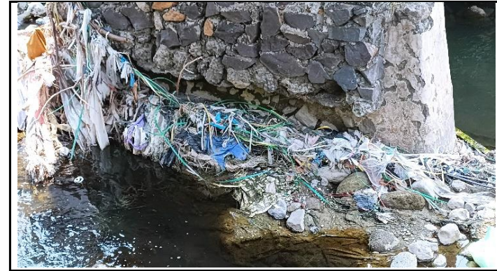
KONDISI PILAR TERJADI PENUMPUKAN SAMPAH
