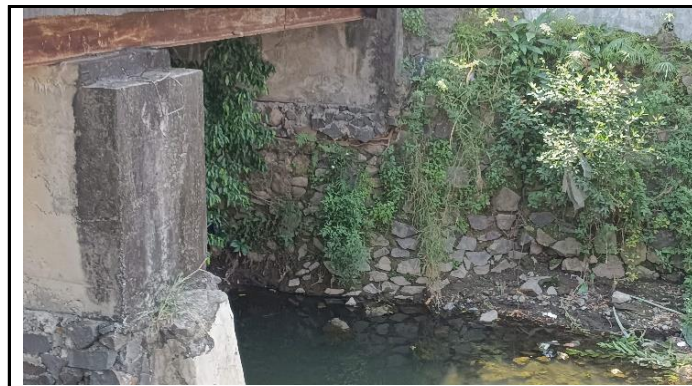
KEPALA JEMBATAN MENGALAMI PENURUNAN MUTU
