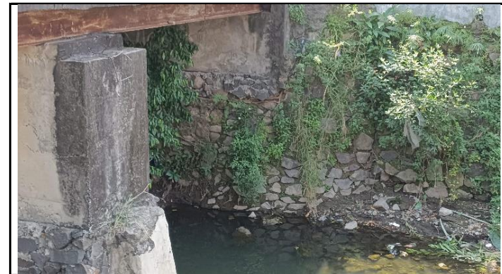
KEPALA JEMBATAN MENGALAMI PENURUNAN MUTU
